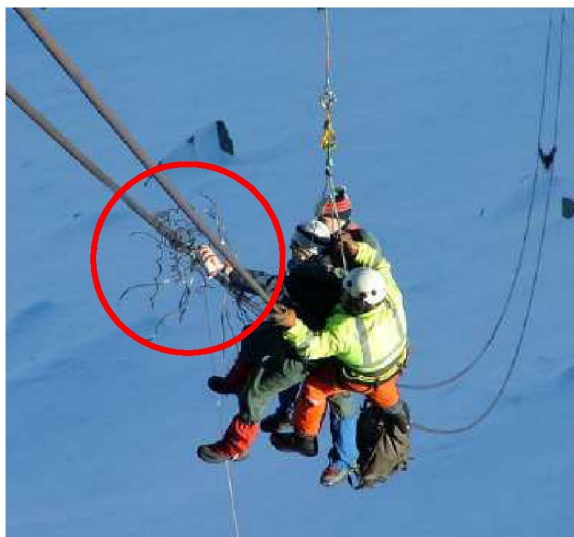
Рисунок 2-8: Повреждение направляющих канатов [6]
