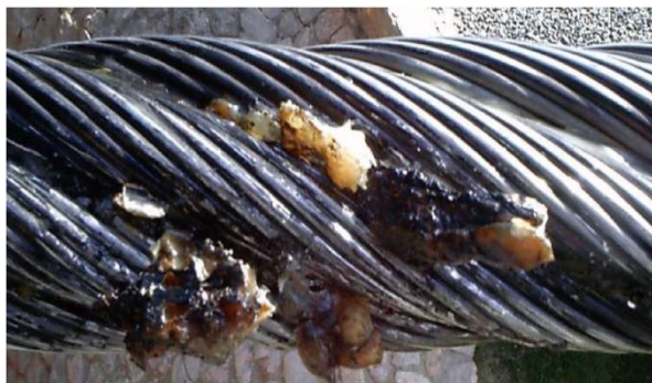
Рисунок 2-12: Удар молнии по многопрядному канату, с очень сильными повреждениями
