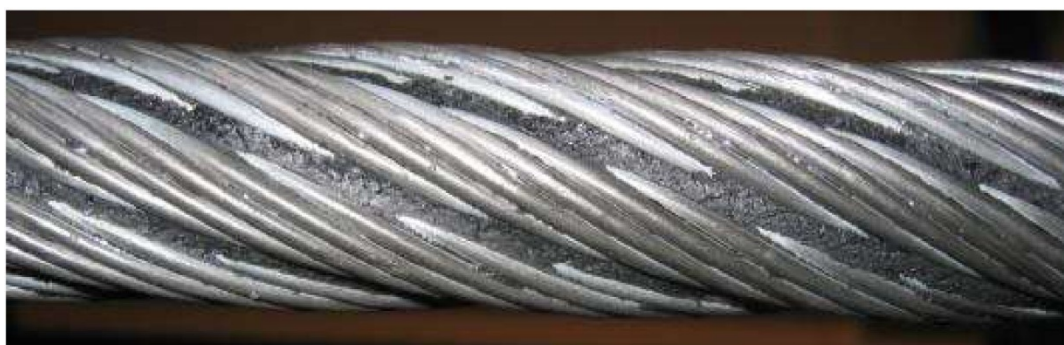
Рисунок 14: Грязь в зоне контакта прядей - контроль затруднен
