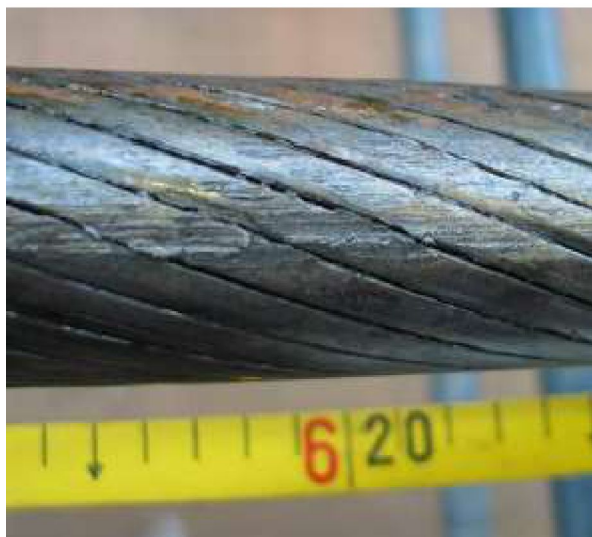
Рисунок 2-9: Повреждение направляющего каната - фрагмент [6]
