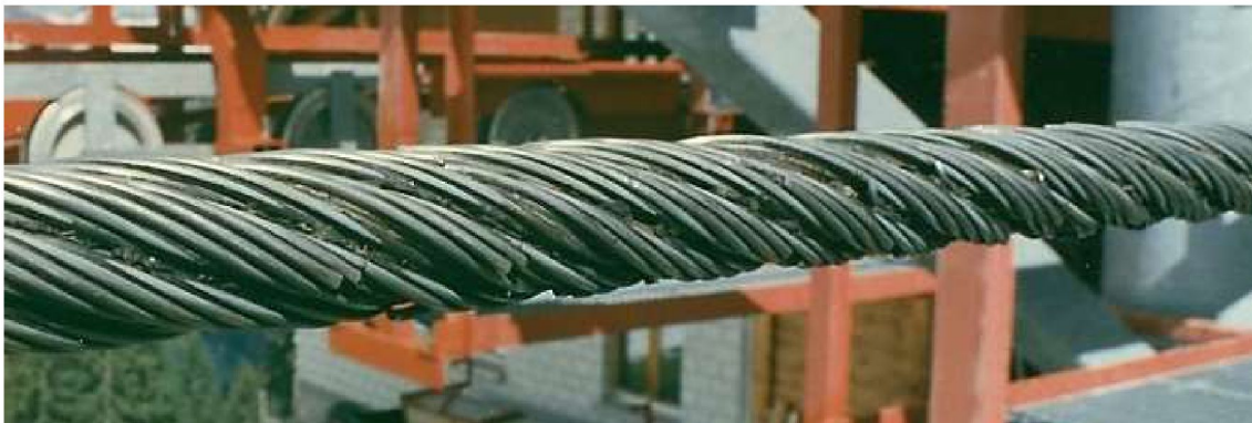
Рисунок 2-1: Повреждения, вызванные проскальзыванием крепежного зажима
