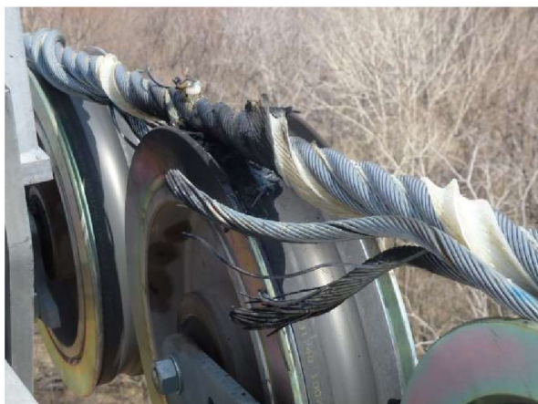
Рисунок 2-6: Повреждения из-за прохождения тока
