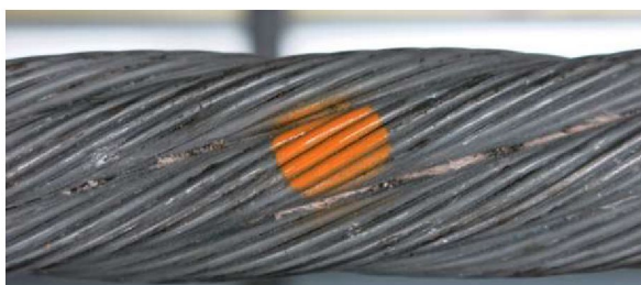
Рисунок 4-23: Коррозия размером 1,0 диаметр пряди
