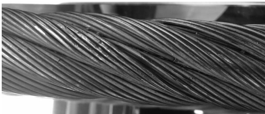
Рисунок 5-25: Повреждения, которые удалось обнаружить во время контроля
